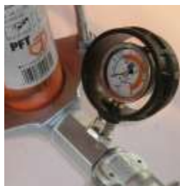
Рис. 26: Манометр давления раствора
