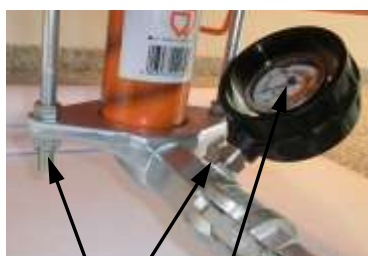
Рис. 79: Манометр давления раствора
